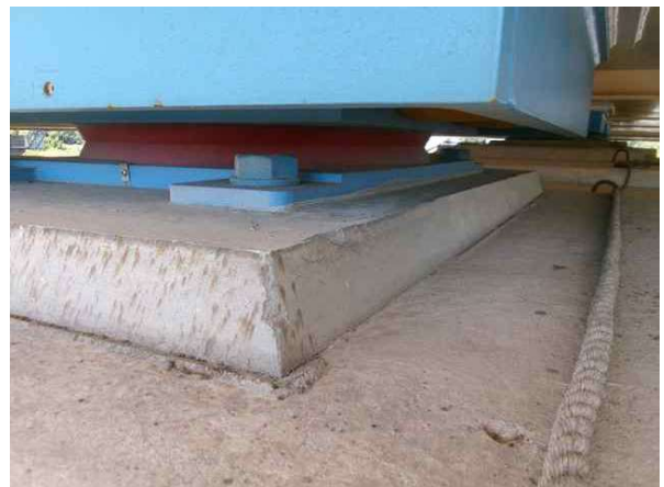
P2-Sh1 받침몰탈 파손 (0.1m×0.1m)
