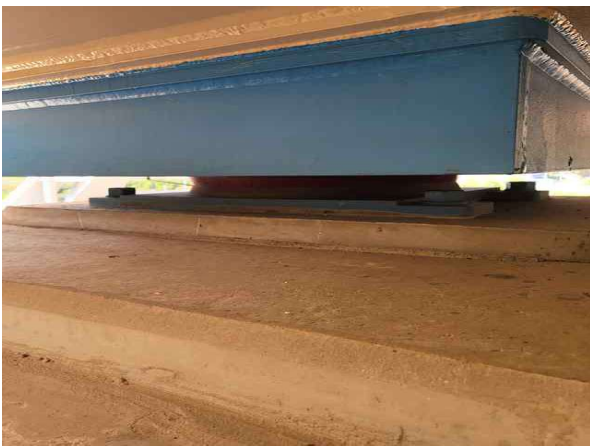
P1-Sh1 받침몰탈 균열 (0.2mm/0.4m×5EA)
