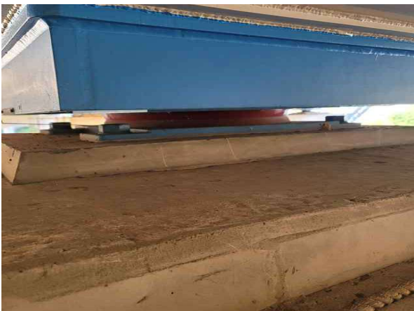
P1-Sh3 받침몰탈 균열 (0.2mm/0.4m×4EA)
