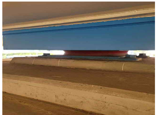
P1-Sh2 받침몰탈 균열 (0.2mm/0.4m×3EA)
